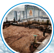
排水処理槽 (曝気)
